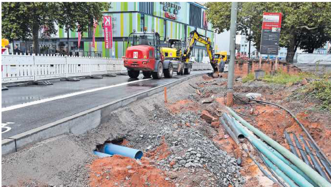
Im Zuge der Bauarbeiten wurden bereits Rohre für die geplante Erlebarmachung der Lauter gelegt
